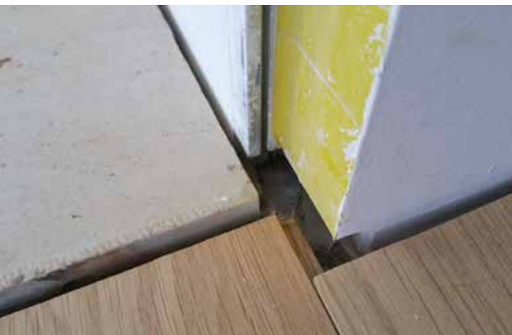
Špatně – detail zapuštěných zárubní.
