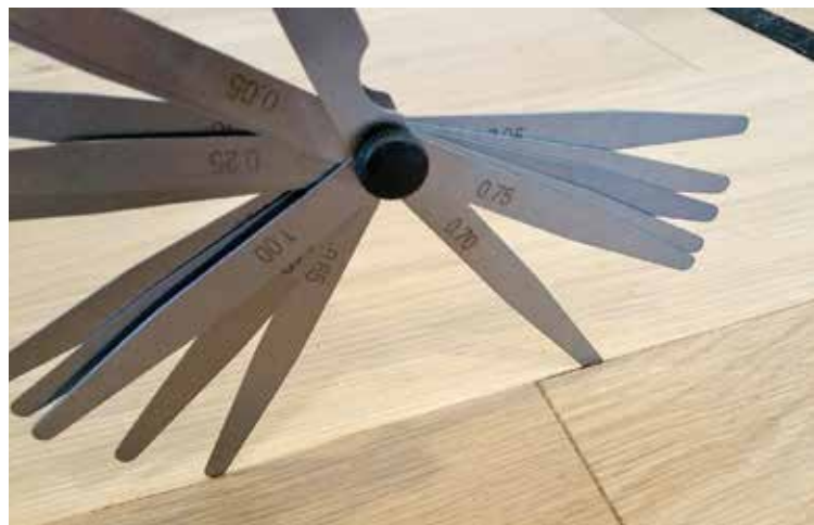
Špatně stažená podlaha.
